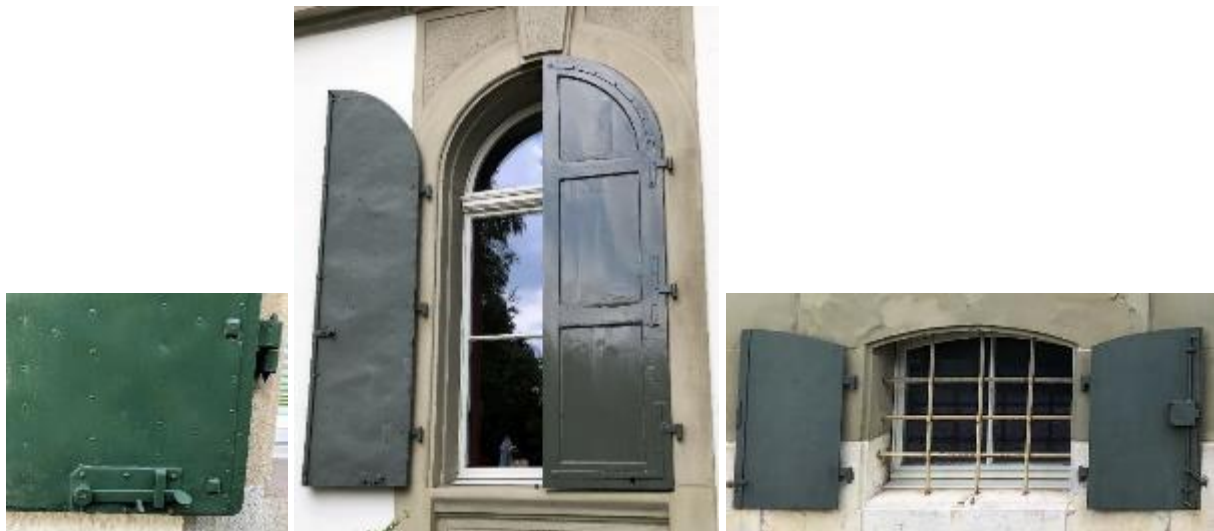
Abb. 128 bis 130: Alle in Langenthal. Links: Träger in Holz, beidseitig mit Eisenblech belegt, sichtbar mit Rundkopfnägeln befestigt. Mitte: Laden nur einseitig mit Blech verkleidet. Rechts: Laden für Kellergeschoss aus Ganzmetall. Die Beschläge sind interessant: Links spezielle Windfalle zum Heben, Mitte Espagnolette, rechts Espagnolette mit Kastenschloss zum Abschliessen mit Schlüssel durch den Laden von aussen.
