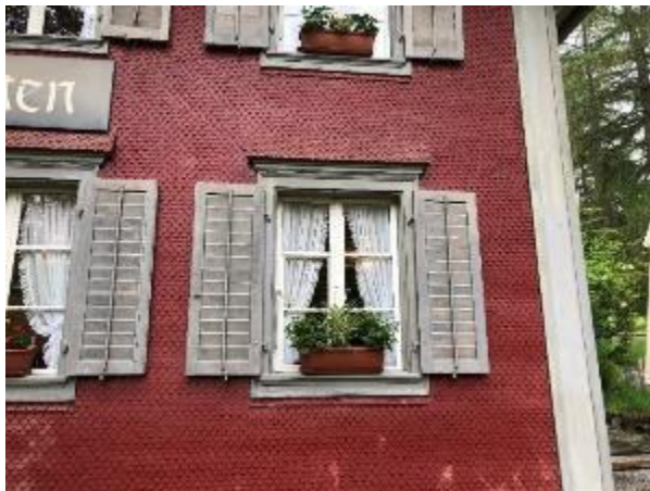
Abb. 192: Typische Biedermeier-Fenster, Läden mit beweglichen Lamellen. Verschluss mit Sperrstange, Rückhalter aus Gusseisen.
