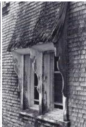
Abb. 281: Schuttdach auf der Wetterseite mit offenen Fallläden.
