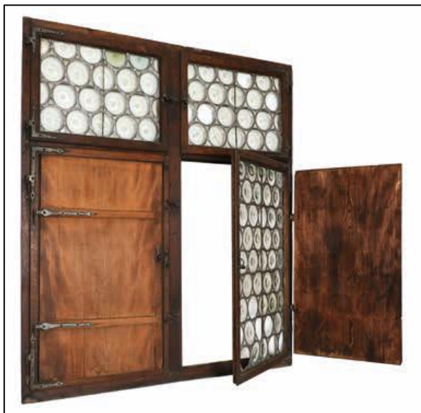
Abb. 168: Barockes Kreuzstockfenster mit gerateten Innenläden. Beschläge: Stützkloben mit Langbänder, als Verschluss Vorreiber.
